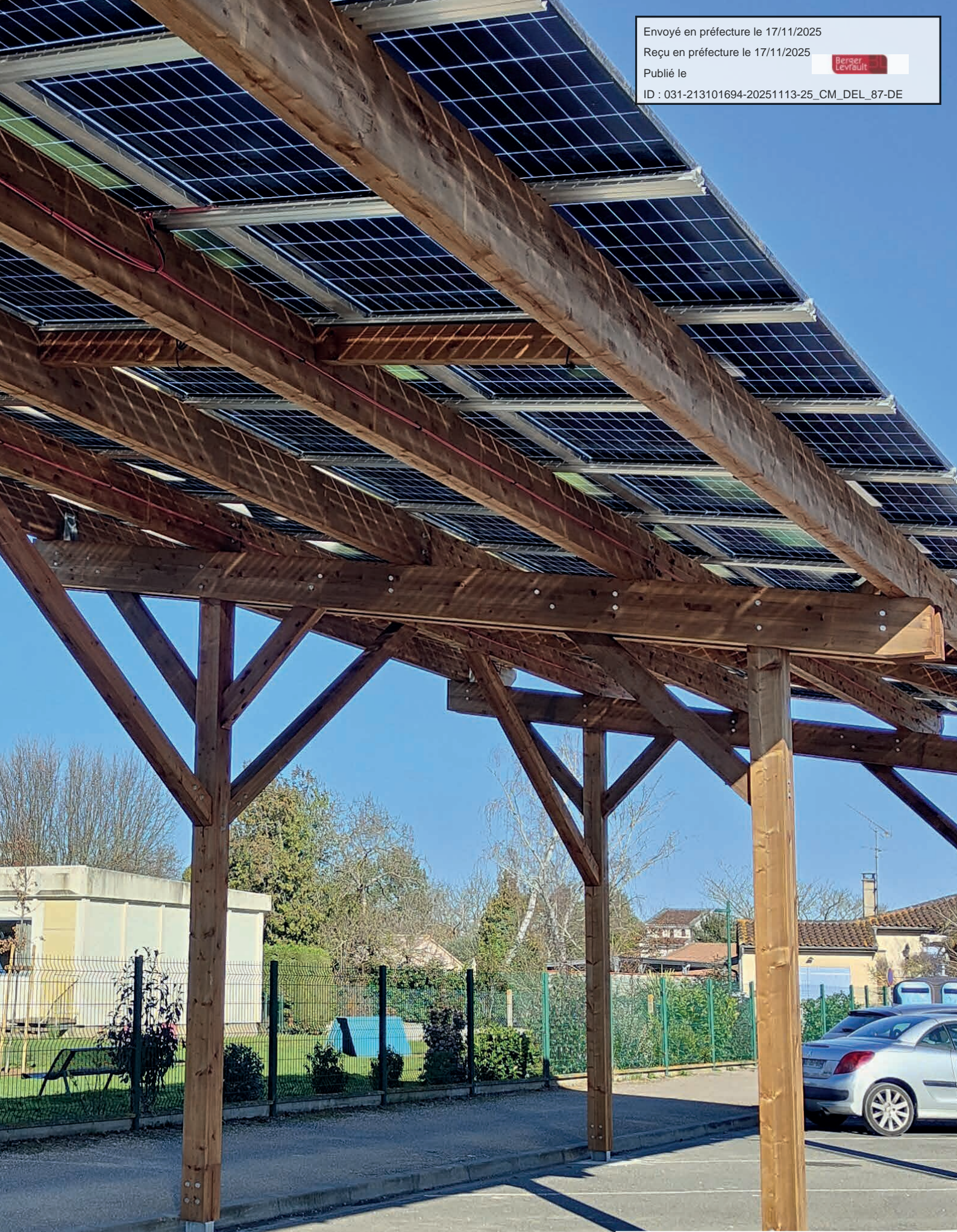
Ombrière photovoltaïque en autoconsommation installée par le SDEHG à Labastidette.
