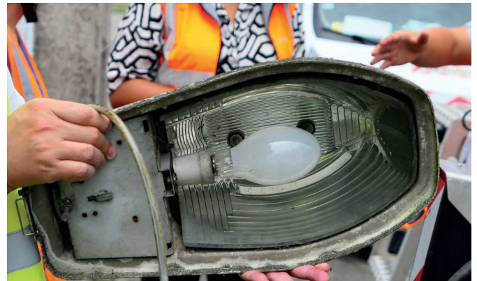
Ancien luminaire Sodium haute pression (SHP) déposé dans le cadre du programme LED Haute-Garonne 2026++
